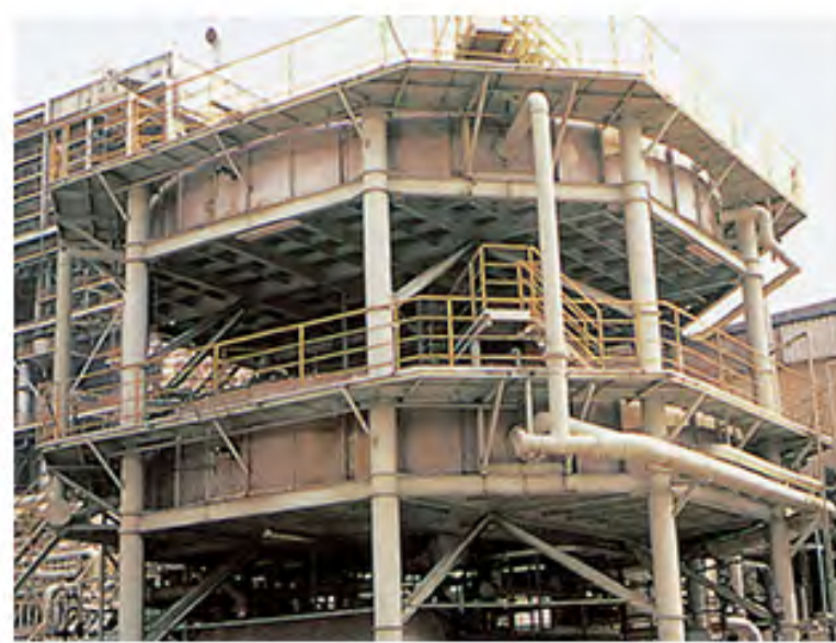
加圧浮上設備
