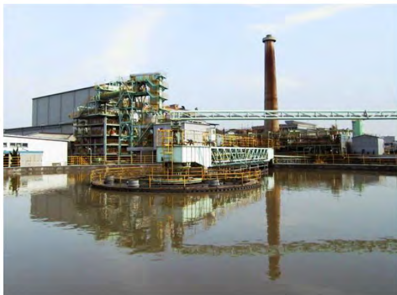
凝集沈殿設備
